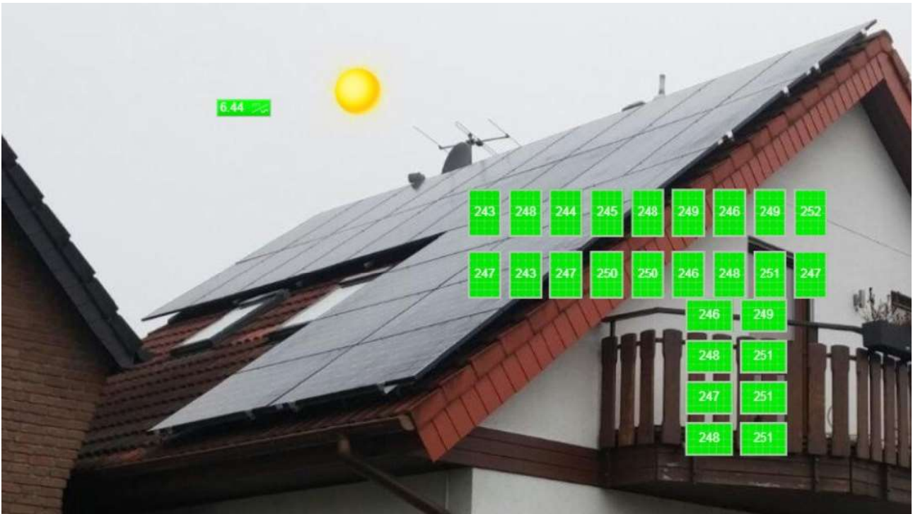
7,5kwp mit Tigo Optimierern und dem Hauskraftwerk von E3/DC (2016)
